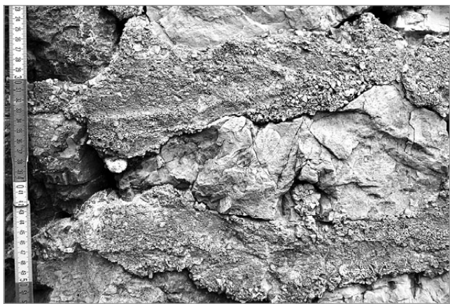
fig. 3 – Vigo di Ton, castel San Pietro. Particolare della malta di finitura sui paramenti interni del mastio circolare (periodo I).
