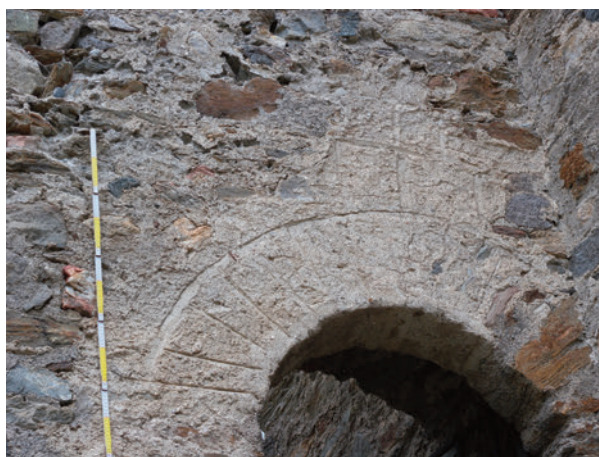
Fig. 11. Castello Nuovo, paramento esterno est del circuito difensivo di periodo I, fase II. Particolare della finitura dell'intonaco, liscio a scivolo in senso orizzontale e verticale, a "falsa cortina", in corrispondenza della postierla (foto dell'Autrice).
