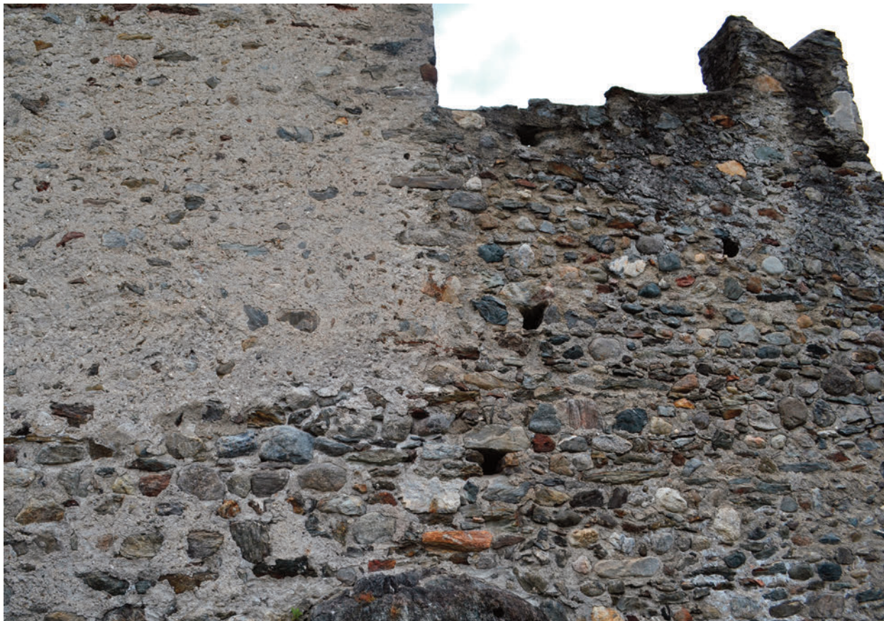
Fig. 9. Castello Nuovo, rapporto stratigrafico di coevità tra seconda cinta di periodo I, fase II, a destra, e primo perimetro difensivo di periodo I, fase I, a sinistra (foto I. Zamboni).
